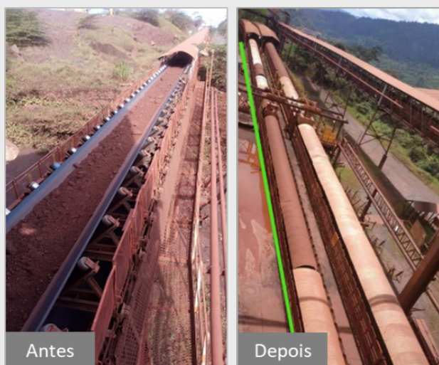
Figura 4: Cobertura de correias transportadoras.
